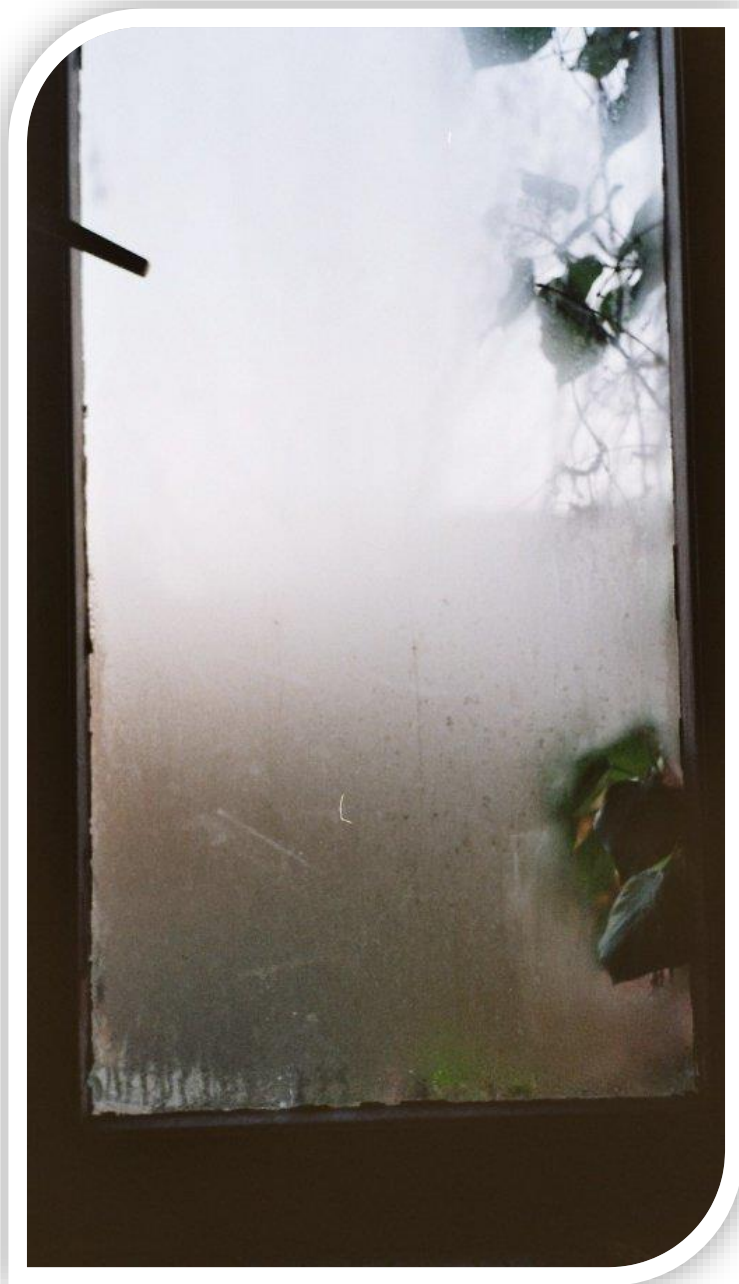
Figure 4 : Buée sur une fenêtre
