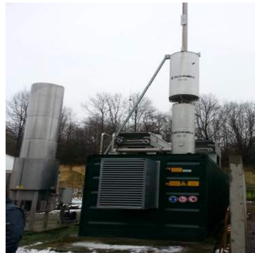
Cogénérateur de Beauval
