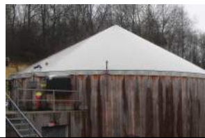
Digester n°1 (1800 m 2 ) : cuve de méthanisation produit 90 % du biogaz
