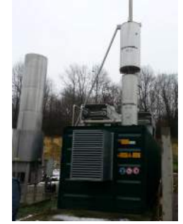
Moteur de cogénération
